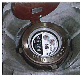
水道メーター
